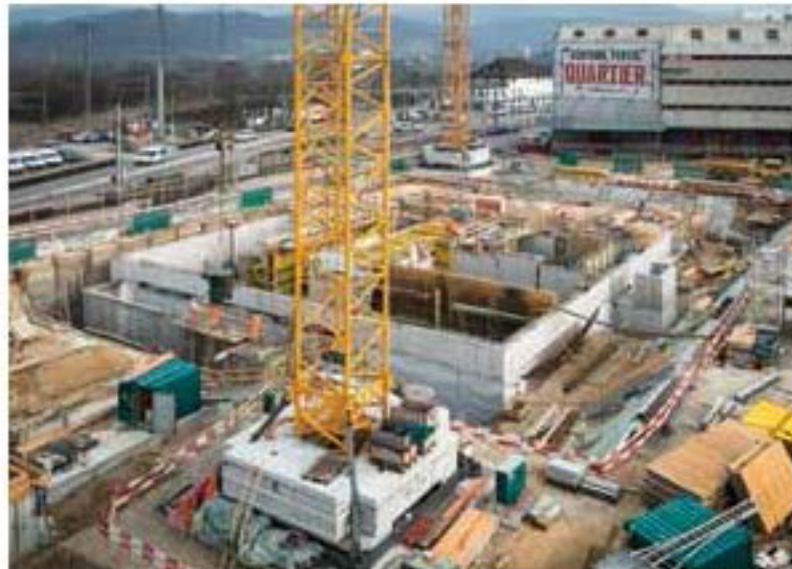
Das zukünftige Hochhaus der HGK FHNW im Dreispitzareal ist im Bau Le futur bâtiment de la HGK FHNW (UT) en construction au Dreispitz.
